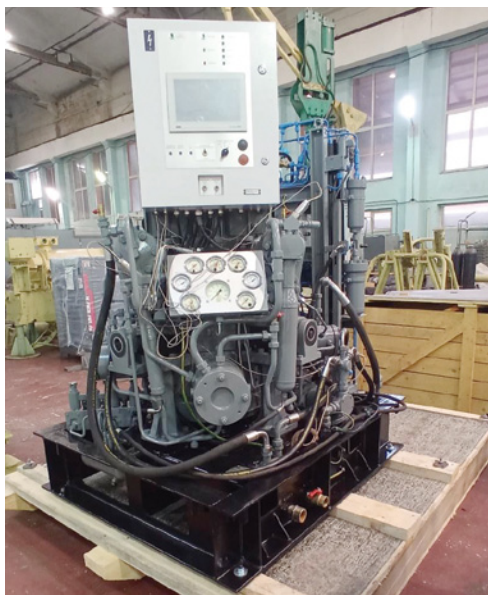
Рис. 2. Прибор управления ПУ СКА60/200 на компрессорной станции
